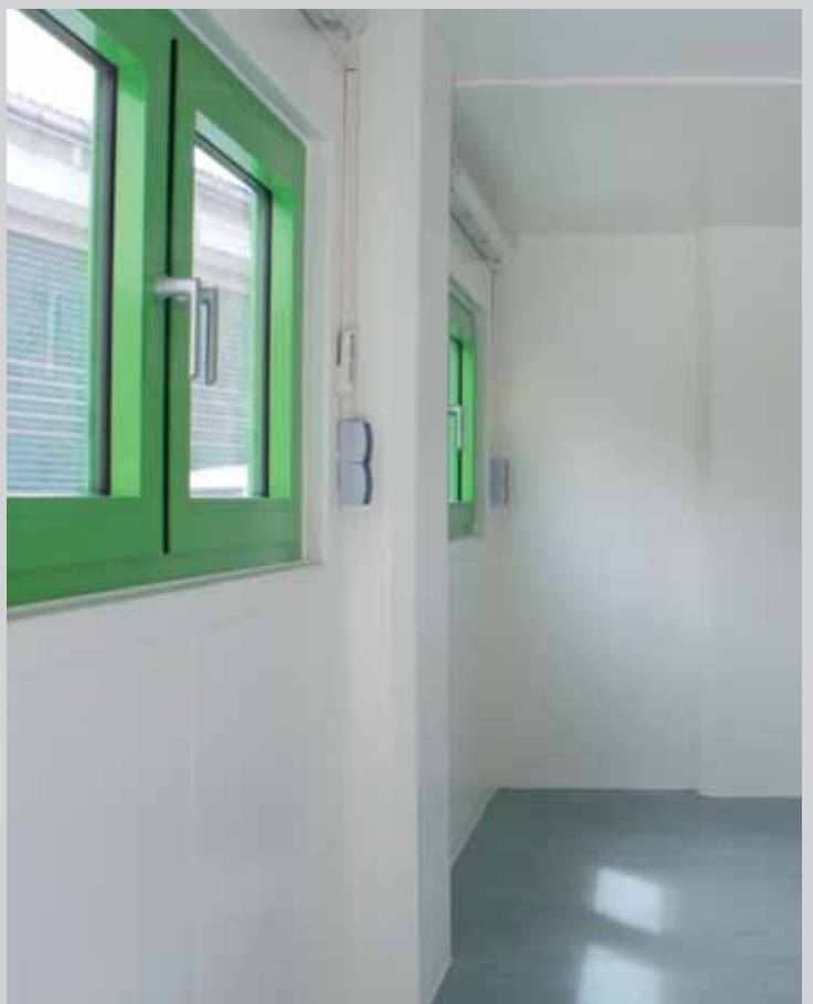
Innenansicht des Office-Containers
