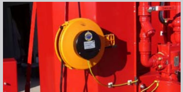
E) Potentialausgleich mit Kabeltrommel und Stecker
