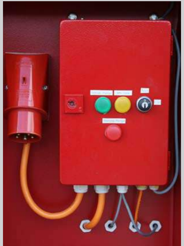
G) Steuerung mit Fremdversorgung AC 400V 32A
