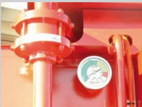
H) Flammensperre (Ex-Ausstattung)
